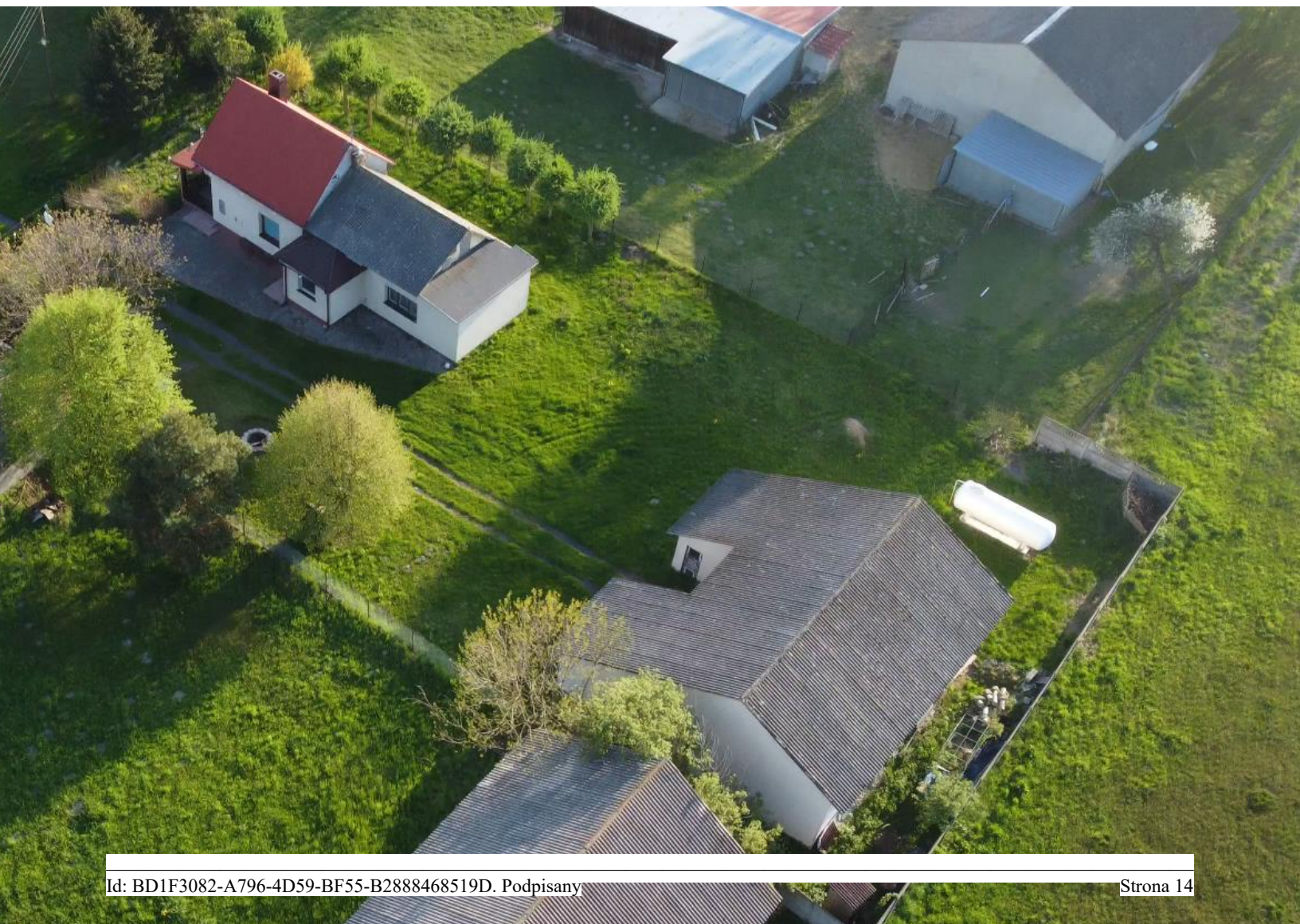
Fot. 1. Wykorzystanie wyrobów azbestowych jako pokrycia dachowe.
